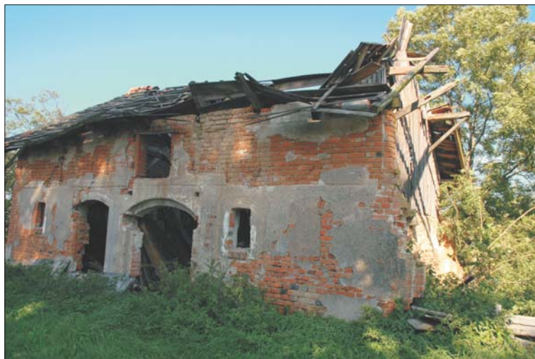
Rys. 1. Niszczące zabudowania we wsi Widryny (fot. A. Martuszewski)
